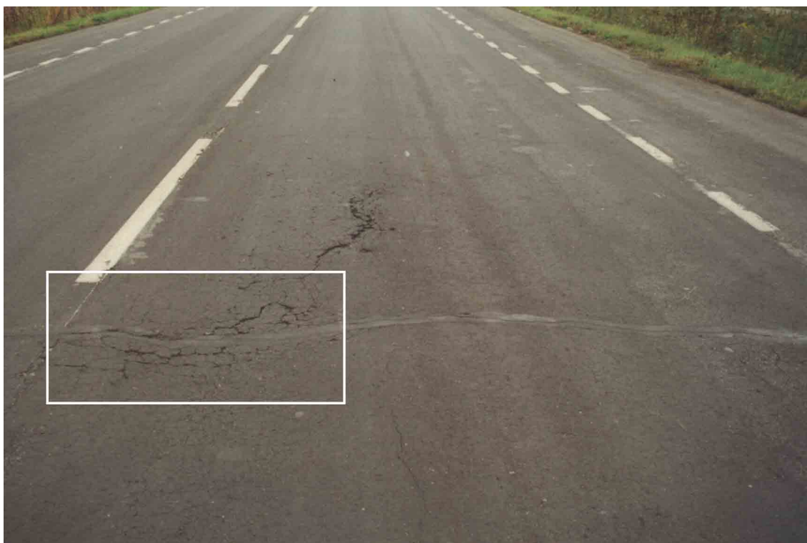
Fot. 3. Pęknięcie siatkowe z licznymi wykruszeniami, za wyróżnionym obszarem przechodzi w pęknięcie pojedyncze podłużne o dużej szkodliwości z uwagi na wykruszenia i siatkę pęknięć wzdłuż krawędzi.
