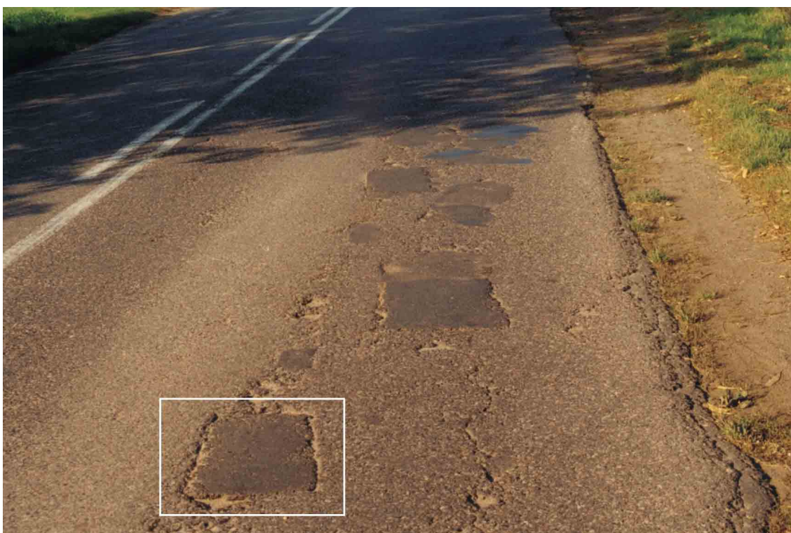
Fot. 34. Na połączeniach łaty znajdują się pęknięcia ze znacznymi wykruszeniami.
