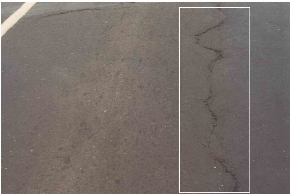
Fot. 14. Wzdłuż krawędzi widać siatkę pęknięć, lokalnie krawędź pęknięcia jest również wykruszona.
