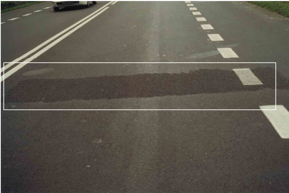
Fot. 35. Łata szczelnie połączona z resztą nawierzchni.
