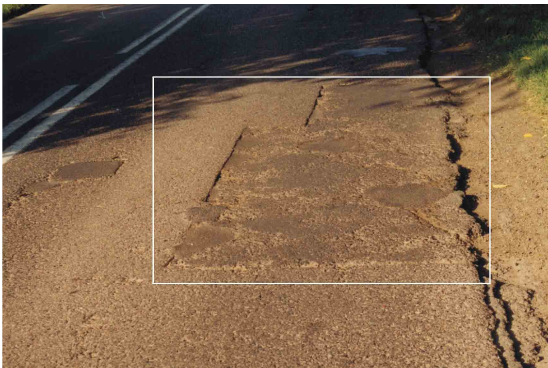
Fot. 37. Łata dużej szerokości, chociaż nie zajmuje całej szerokości pasa ruchu, połączenia są nieszczelne, dają się zauważyć pęknięcia również na jej powierzchni.
