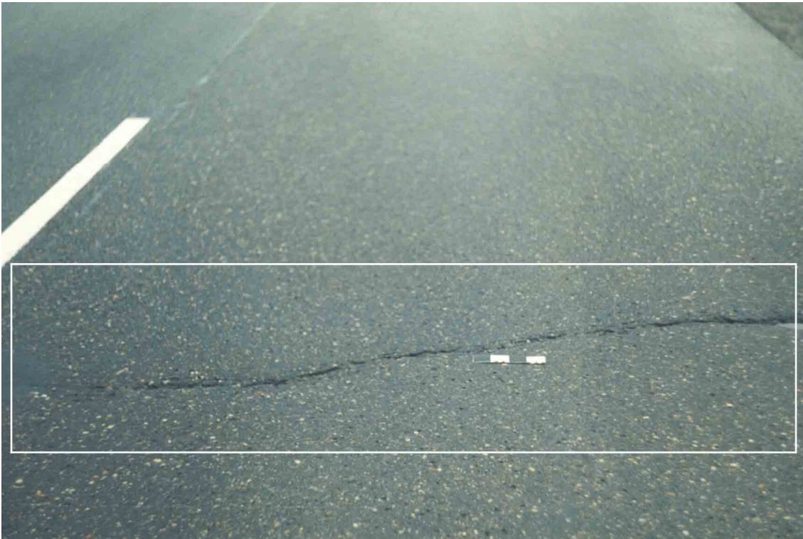
Fot. 27. Krawędź pęknięcia prawie na całej długości ma wykruszenia. Długość wzorca 20 cm.
