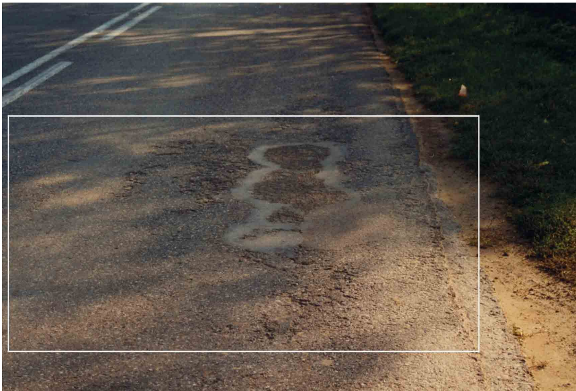
Fot. 45. Bardzo silne ubytki bliskie powstania wybojów.
