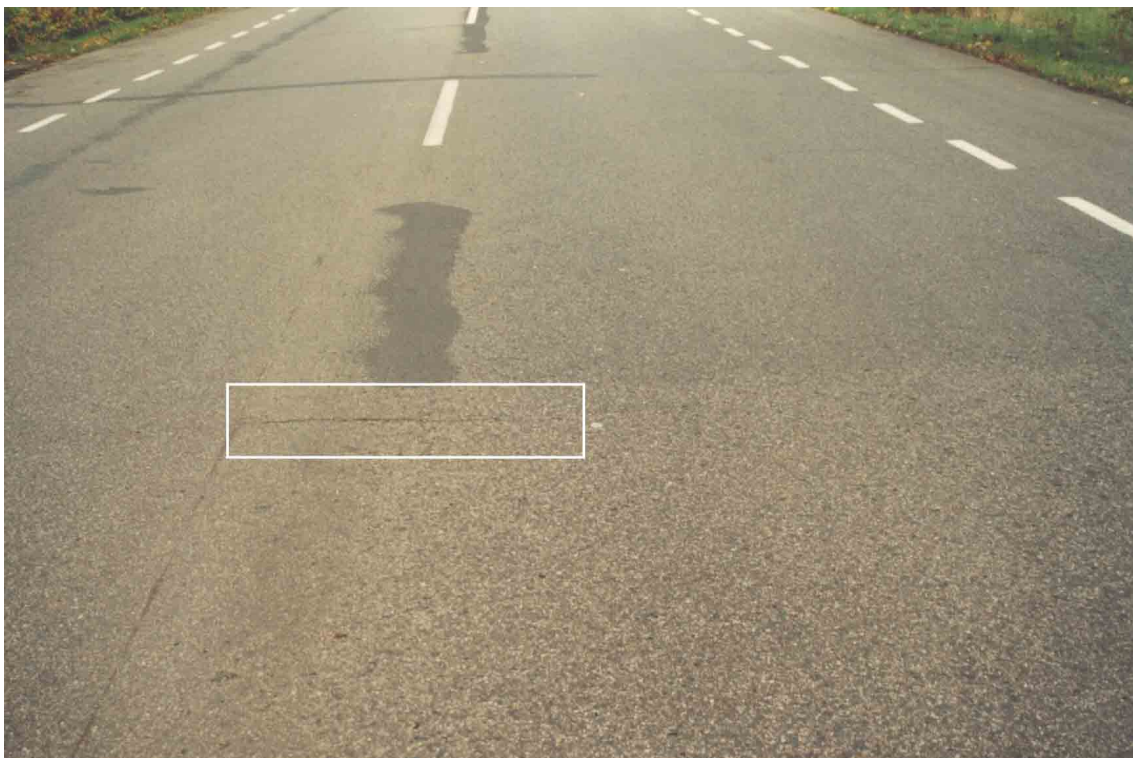
Fot. 19. Pęknięcie krótkie, mało rozwarte i bez wykruszeń.
