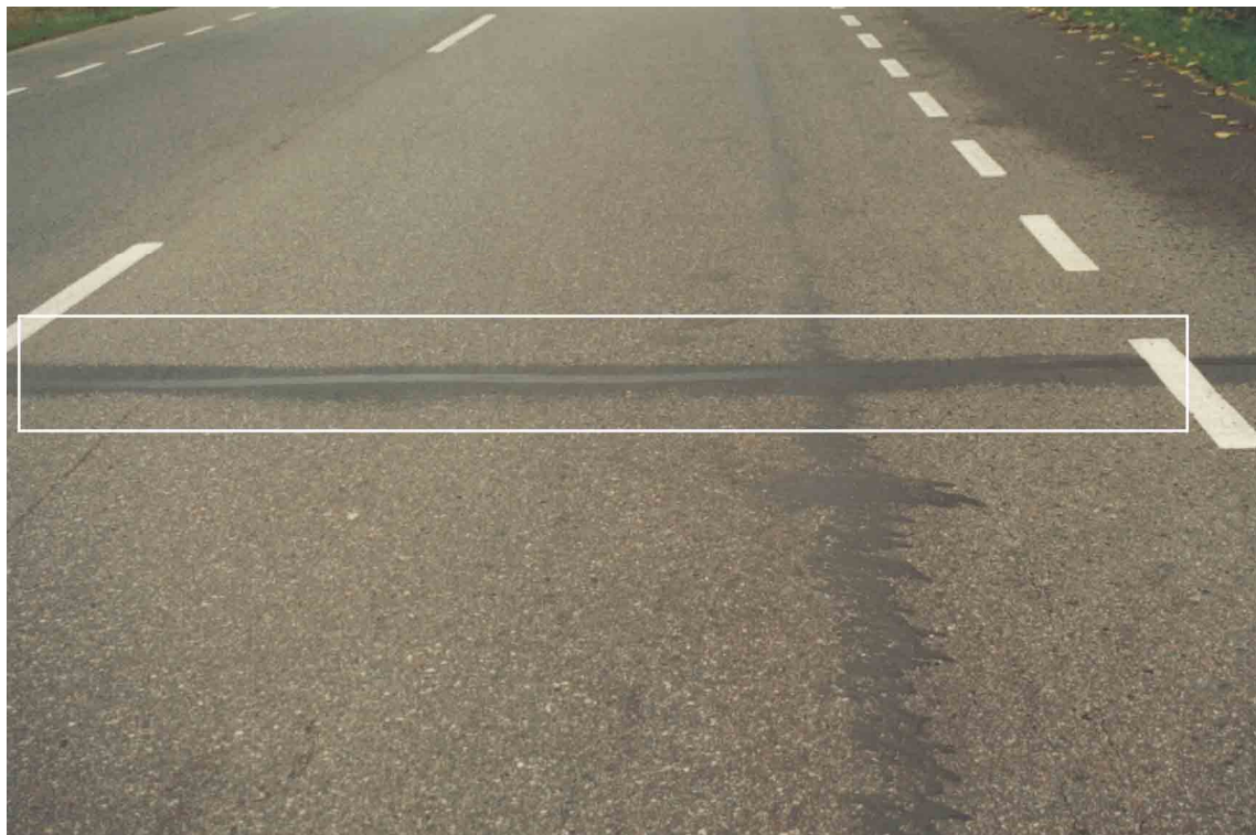
Fot. 22. Pęknięcie zalane i szczelne.
