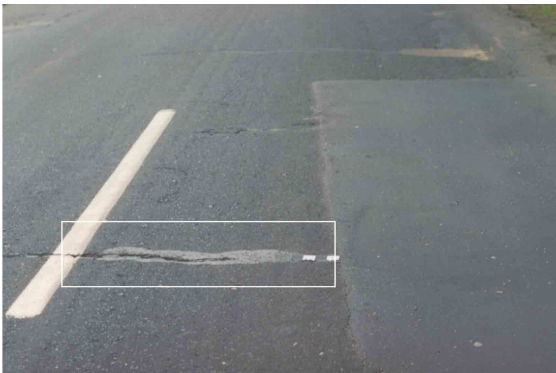
Fot. 26. Pęknięcie zalane ale ponownie nieuszczelne, z dużymi wykruszeniami na większości długości pęknięcia. Długość wzorca 20 cm.
