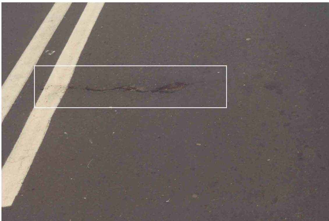
Fot. 25. Pęknięcie z bardzo dużymi wykruszeniami, które wkrótce mogą przekształcić się w wyboje.
