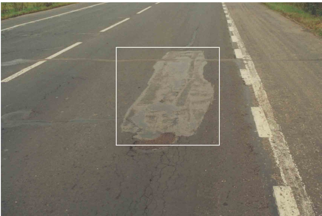
Fot. 33. Łata nieuszczelna, występują pęknięcia na jej powierzchni a także pojawiają się pęknięcia na połączeniu.
