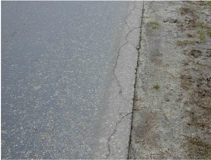
Rys. 4. Przykład uszkodzenia przy krawędzi jezdni, nie szerszego niż 20 cm.
