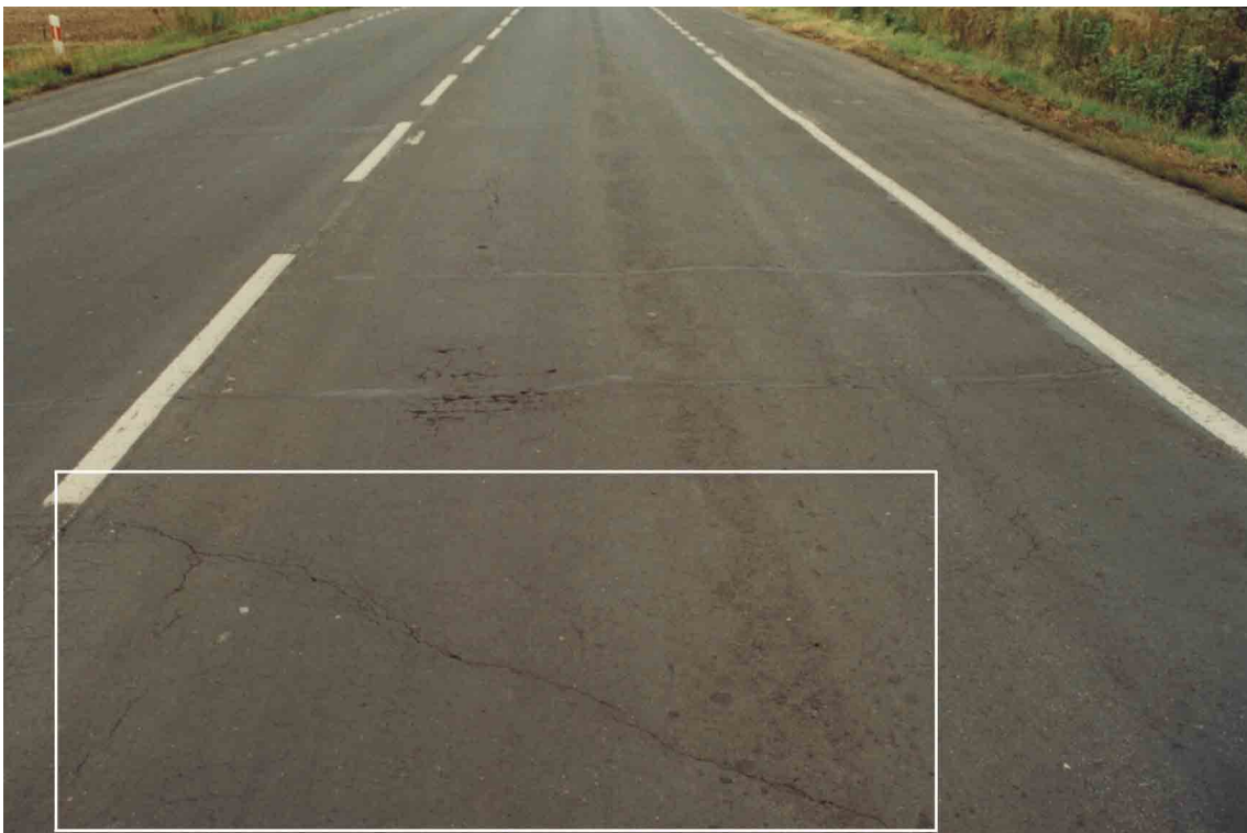
Fot. 30. Pęknięcie podłużne kończy się pęknięciem poprzecznym z siatką drobnych ale wyraźnych szczelin.
