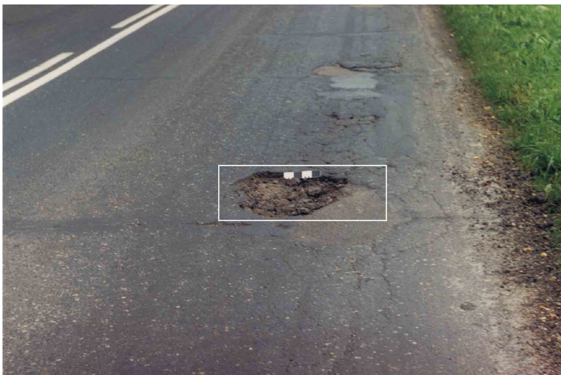
Fot. 41. Wybój, przed którym i za którym występują pęknięcia siatkowe a także pęknięcie poprzeczne. Długość wzorca 20 cm.
